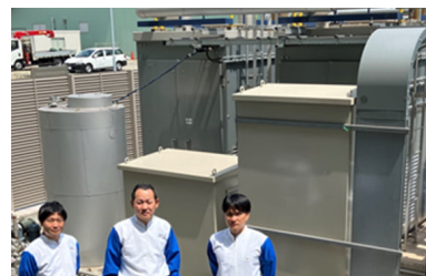
不二製油（株）千葉工場のバイオマスボイラー
